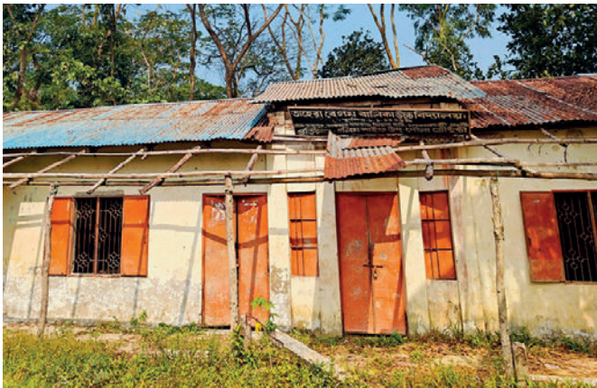
▲ Bangladesch: Außenansicht der beschädigten Klassenräume
