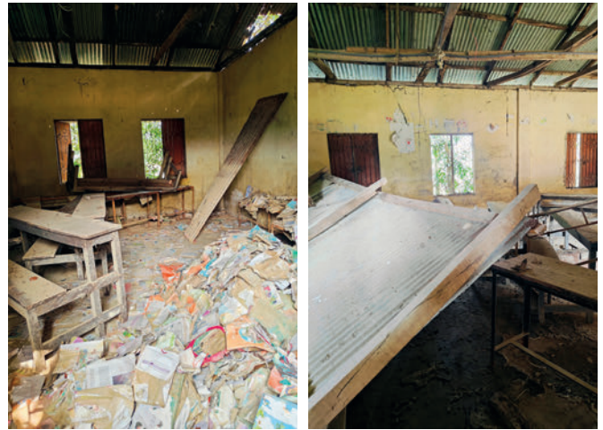
▲ Bangladesch: Innenansicht der beschädigten Klassenräume
