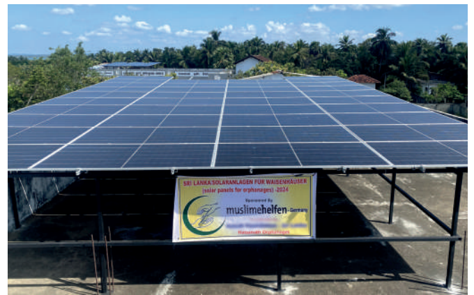
▲ Kinniya, Sri Lanka: Solaranlage auf dem Dach des Waisenhauses.
